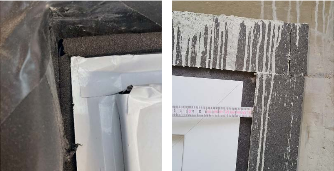
Abbildung 51: Kleine Leckagen, Fehlstellen und Undichtigkeiten können mit einem geeigneten MS-Polymer-Dichtstoff nachgebessert werden. Beide Bilder zeigen Fehlstellen: links eine „kleine“, bei der das Band zu kurz abgelängt worden ist, rechts eine „große“ bei der das Band entweder stark überstreckt montiert oder viel zu kurz abgelängt worden ist.
