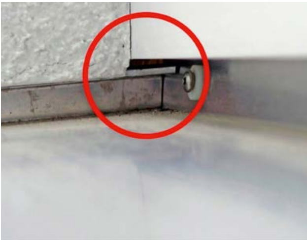
Abbildung 25: Beispielhaft für das „Gewerke Loch“
