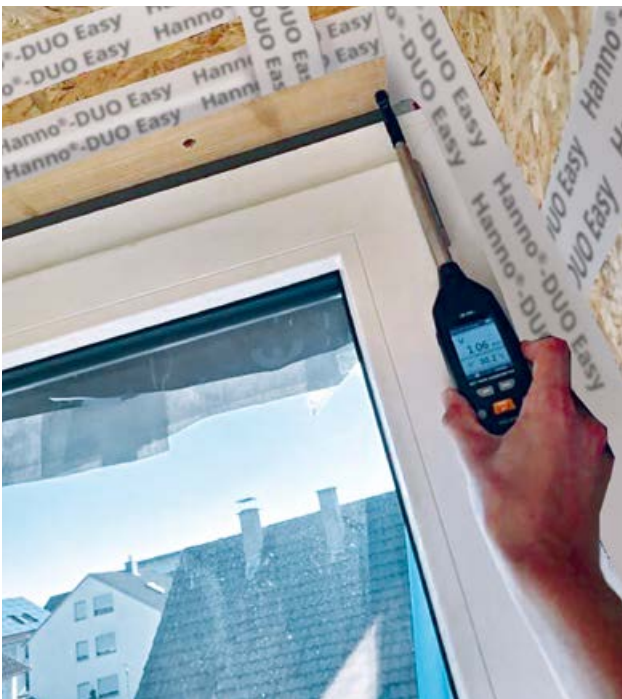
Abbildung 21: Leckagestrom in der Ecke kann durch Leckagen in der Eckausbildungen kommen, muss aber nicht (Beispiel aus einer Blower-Door-Messung)
