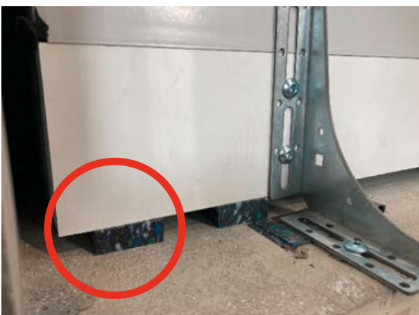
Abbildung 9: Lastabtragende Klötze dürfen nicht vorstehen und Folgegewerke behindern
