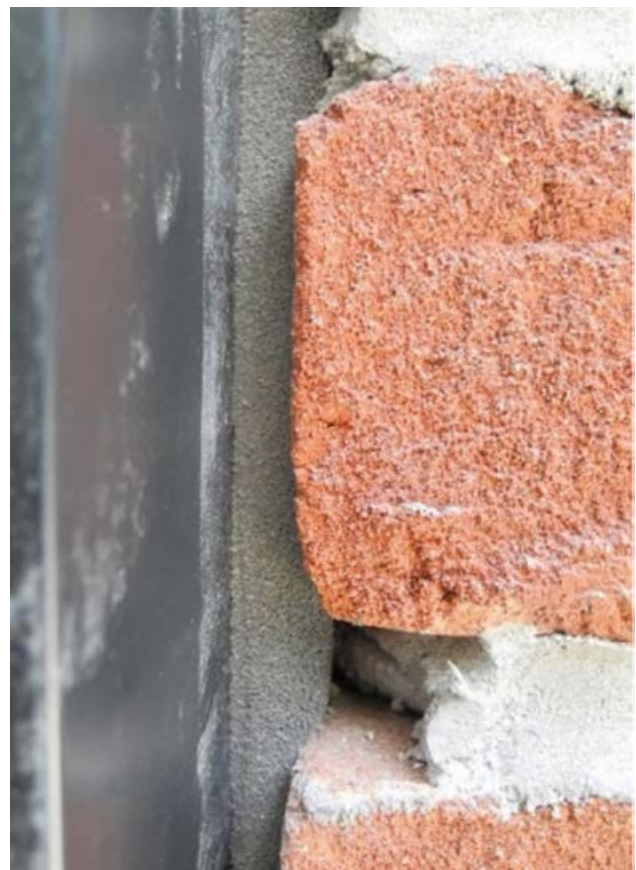
Abbildung 43: Fugendichtungsband mit sehr großem Rücksprung verbaut, Lagerfuge offen. Frage: Kann das ablaufende Oberflächenwasser vom Fugendichtungsband unten abfließen? Ist der AG einverstanden, wenn die Lagerfuge mit farbgleichen Dichtstoff verschlossen wird?
