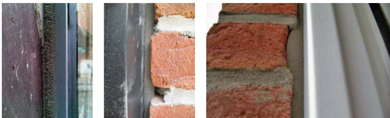
Abbildung 44: Keine saubere Ausführung! Links hat keinen Rücksprung und erfährt sowohl UV- als auch mechanische Belastung. Der große Rücksprung in der Mitte führt mit hoher Wahrscheinlichkeit das Oberflächenwasser nicht kontrolliert ab und die offene Lagerfuge ist nicht schlagregendicht, was zu Schäden führen kann. Rechts kann das Band den Versatz der Steine nicht mehr ausgleichen, geht zu weit auf, ist nicht mehr UV-stabil (da es über den maximalen Fugeneinsatzbereich expandiert ist).
