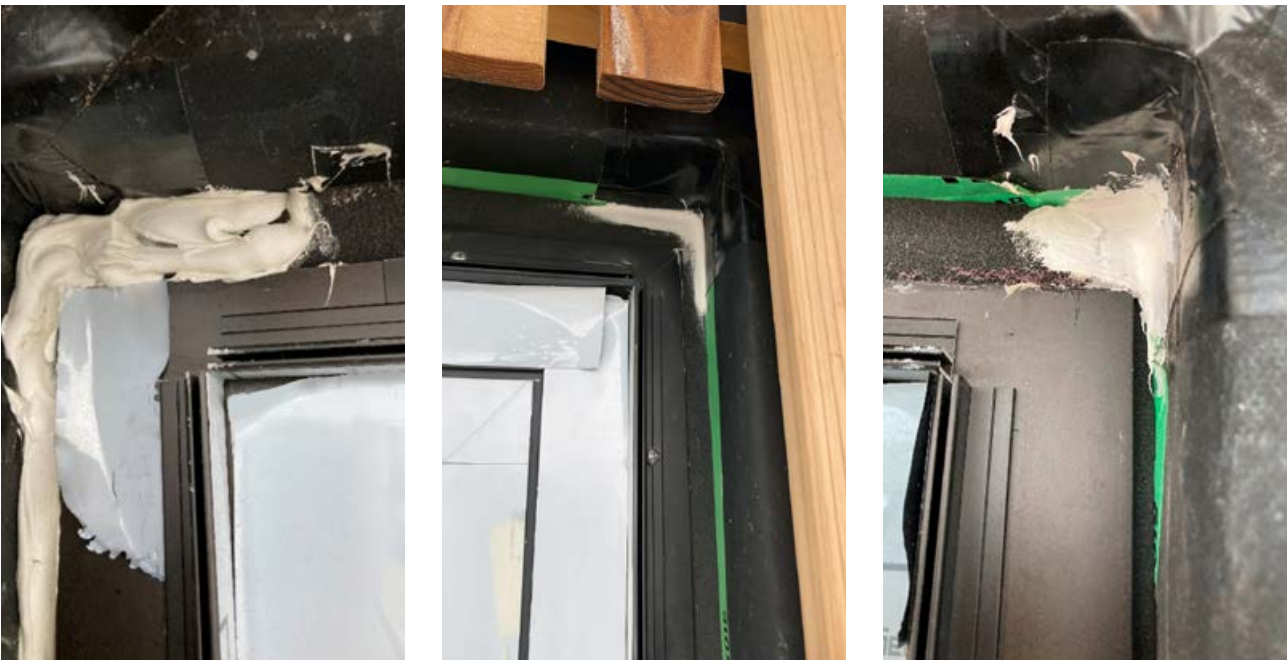
Abbildung 52: Nachbesserungen von Leckagen in der Eckausbildung sind mit geeigneten Polymerklebern, wichtig ist die Überstreichbarkeit und geeignete Dehnfähigkeit, möglich! Im mittleren Bild wurde eine kleine Leckagestelle sauber nachgebessert, im rechten und linken Bild ist die Zellstruktur des Bandes derartig sichtbar, dass in den meisten Fällen von einer starken Überschreitung des Fugeneinsatzbereiches auszugehen ist. Es ist die Regel „So viel wie nötig, so wenig wie möglich“ zu beherzigen.
